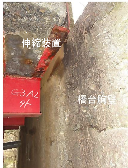
伸縮装置02 : 伸縮装置の腐食
