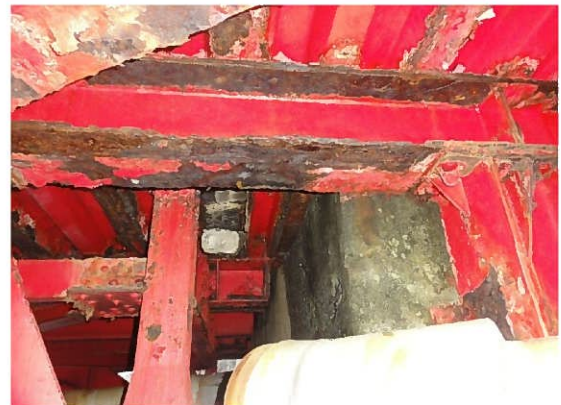
伸縮装置01：縦桁端部の腐食、漏水跡
