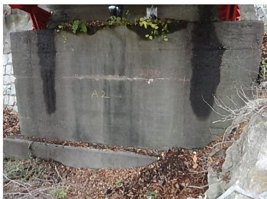
伸縮装置02 : A2橋台に漏水痕
