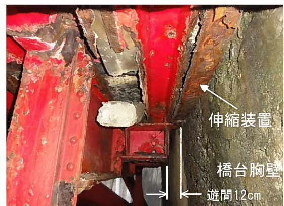
伸縮装置01：伸縮装置腐食
