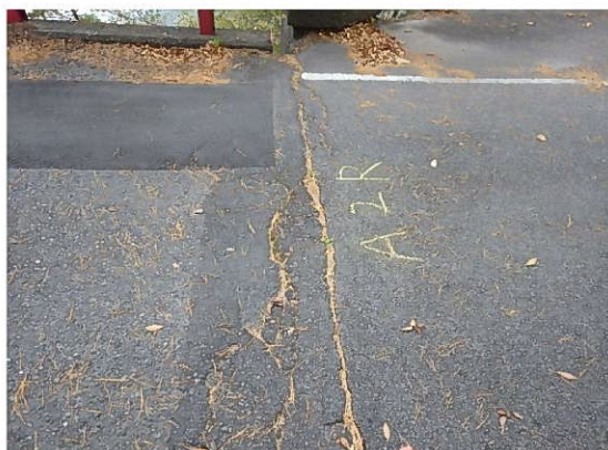
伸縮装置02 : Asf. 舗装オーバーレー、ひびわれ
