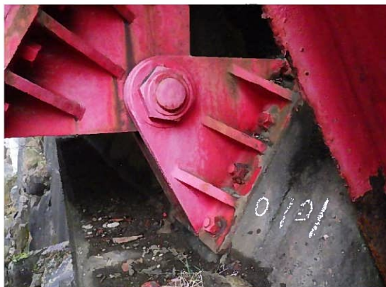
伸縮装置01：支承（0101）の腐食、土砂堆積
