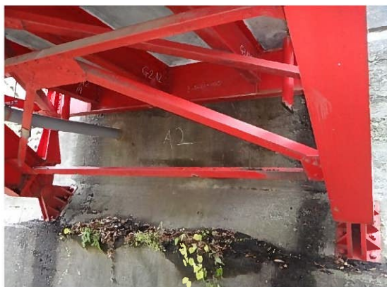
伸縮装置02 : 支承部への漏水、土砂堆積
