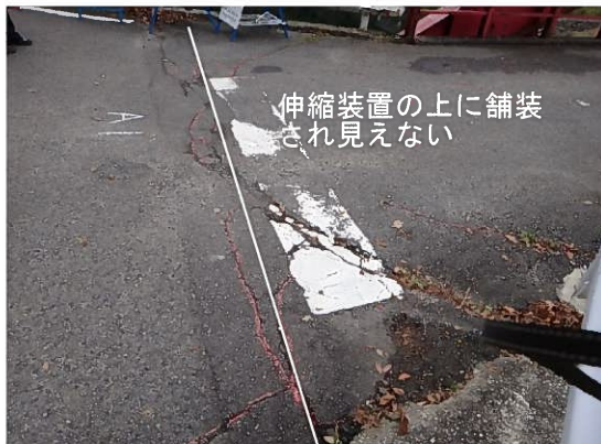
伸縮装置01：Asf. 舗装オーバーレイ、ひびわれ
