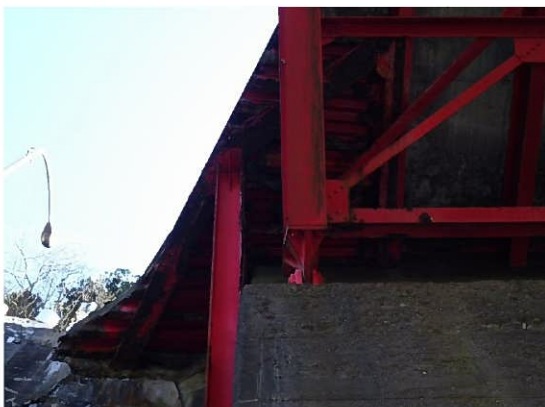
伸縮装置01：縦桁G3、横構の腐食
