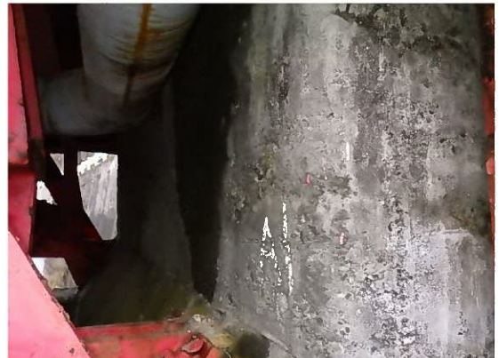
伸縮装置01：橋台に漏水痕
